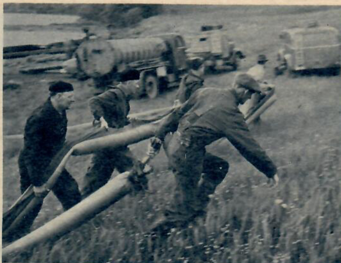
Brandmän och industriarbetare jobbar hand i hand vid rasplatsen i Göta. Den skumfyllda plastslangen läggs ut i rasande fart och oljan inringas.
